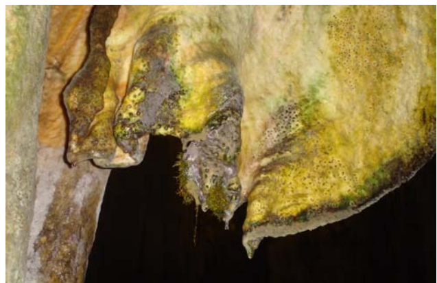
Foto N. 03 – Cortina esverdeada por cobertura de musgos.
